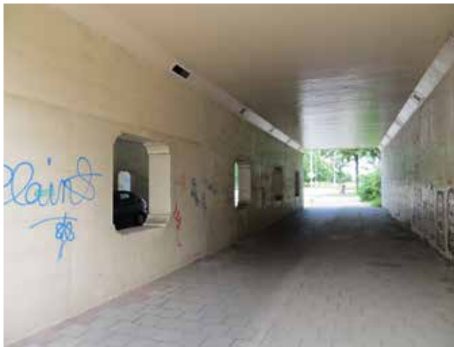
[61] Een tunnel is gemaakt om te passeren. De harde omgeving en het materiaalgebruik maken de onderdoorgang gevoelig voor afval en graffiti.
